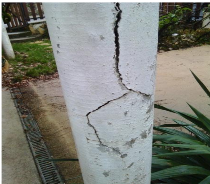
Figure 1-13 : Fissures dans les poteaux
