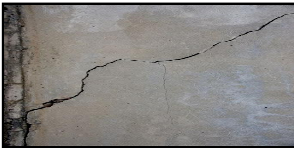
Figure 1-14 : Fissures dans les voiles en béton armé
