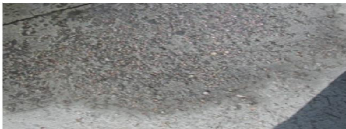
Figure 1-9 : dégradation due aux sels de déverglaçage
