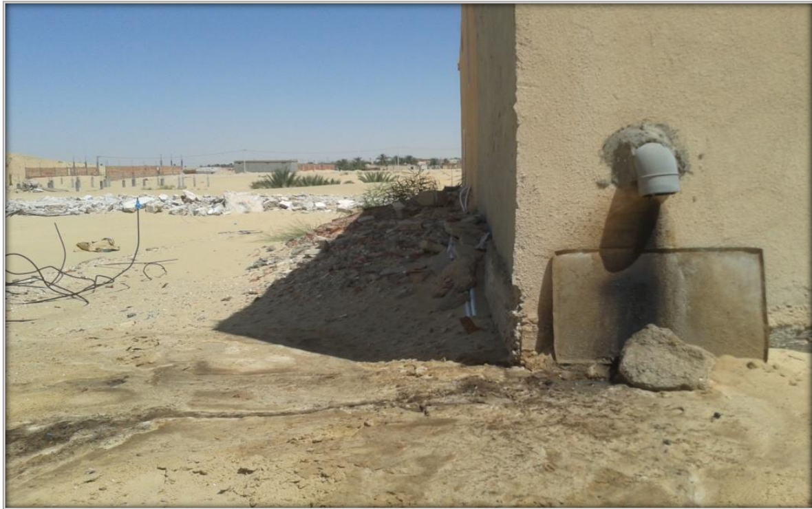
Photo I-2 : Logements non équipés de puits perdus (Mars, 2016).
