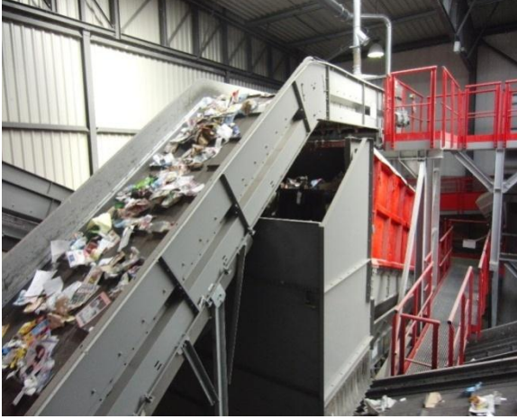
عملية الفرز الأتوماتيكي للنفايات المنزلية
