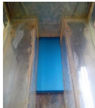
Photo I.5 : Photographie de convergent installé
