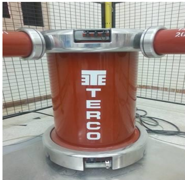
Fig.II.2. Transformateur à haute tension utilisé pour l'essai de claquage de l'air.
