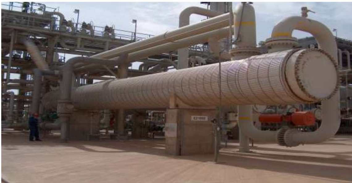
Figure. IV.3 : Exemple d'un échangeur tubulaire.
