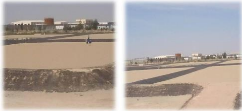
Figure 18: Lit de séchage des boues
