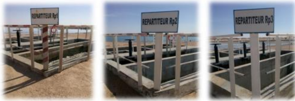
Figure 11: Répartiteur vers les bassins d'aération
