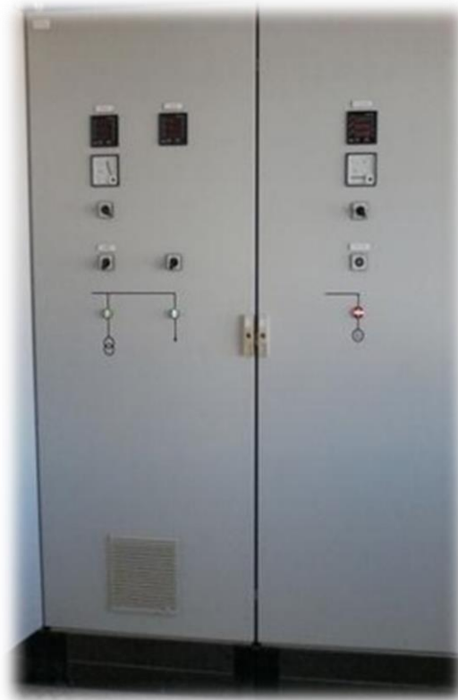
Figure 17: Chambre de contrôle automatique de station de pompage.
