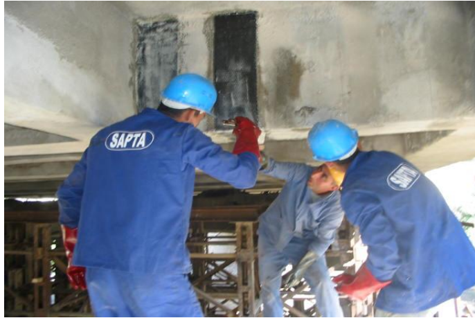
Fig. 4-23 : Imprégnation de la deuxième couche de colle pour coller la deuxième lit de composite
