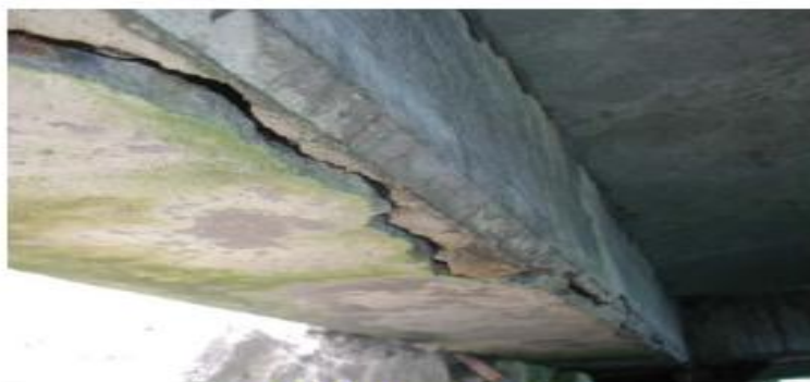
Fig 1-1 : Éclatement Pouter de tablier
