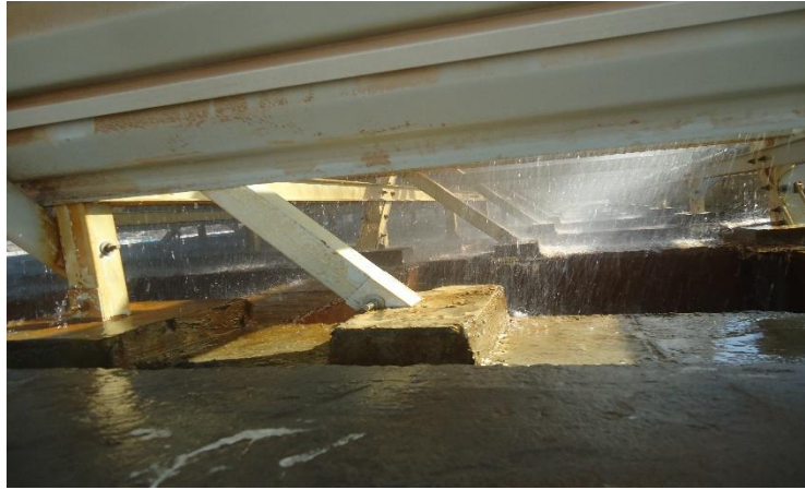
Figure IV. 4: Sortie de l'eau sur le refroidisseur.
