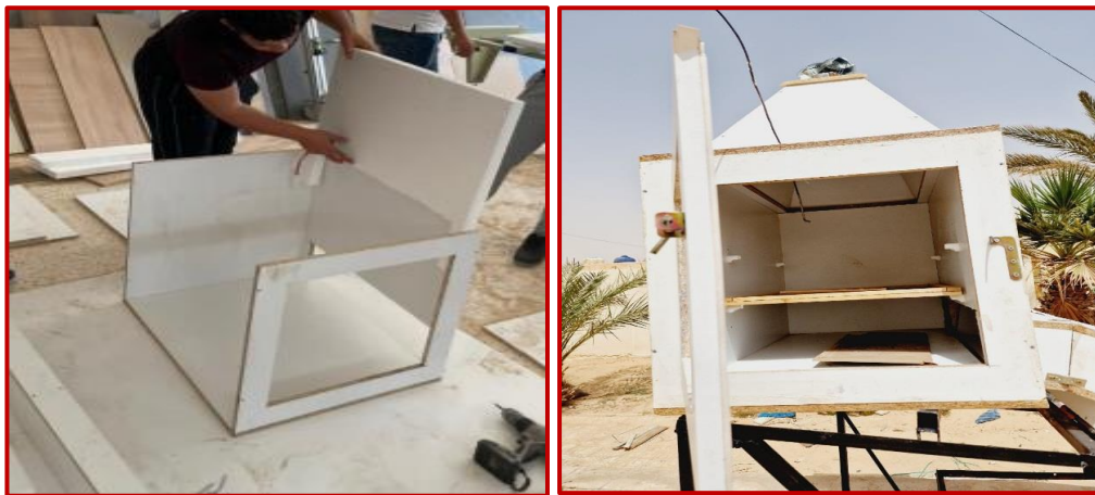
الشكل (II-3): تركيب غرفة التجفيف [1].
