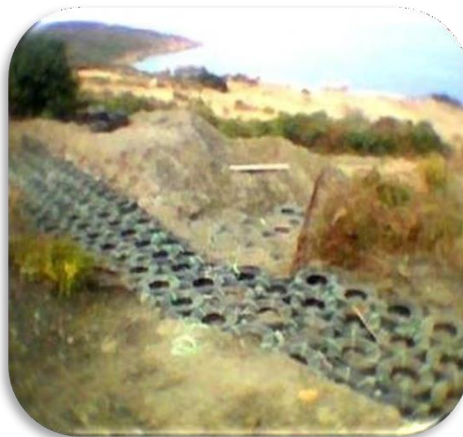
Figure I.10. Ouvrage de mostaghanem RN11 (algérie) stabilité dun talus.
