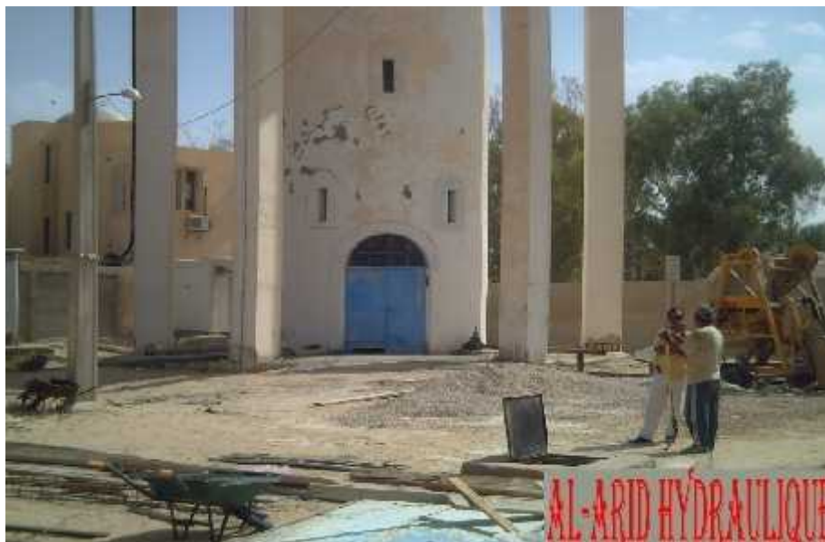
Figure I.9 : château d'eau qui alimente le projet
