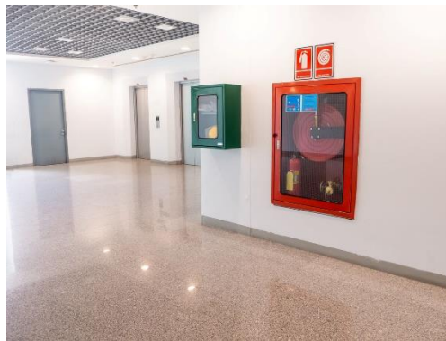
Figure V.4. Porte d'une armoire d'extinction d'incendie en verre
