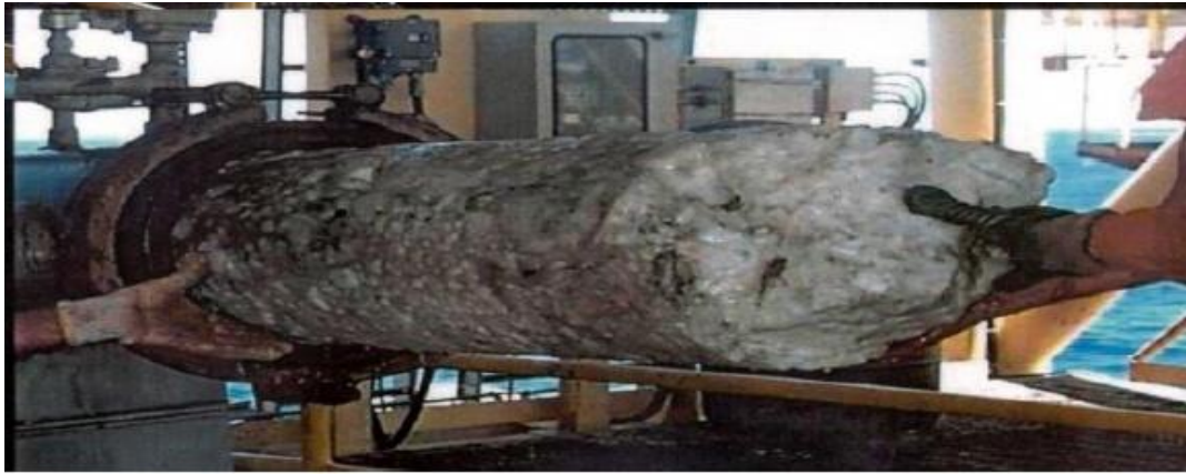
Figure III.3: Bouchage d'une conduite par le givrage des hydrates [23].
