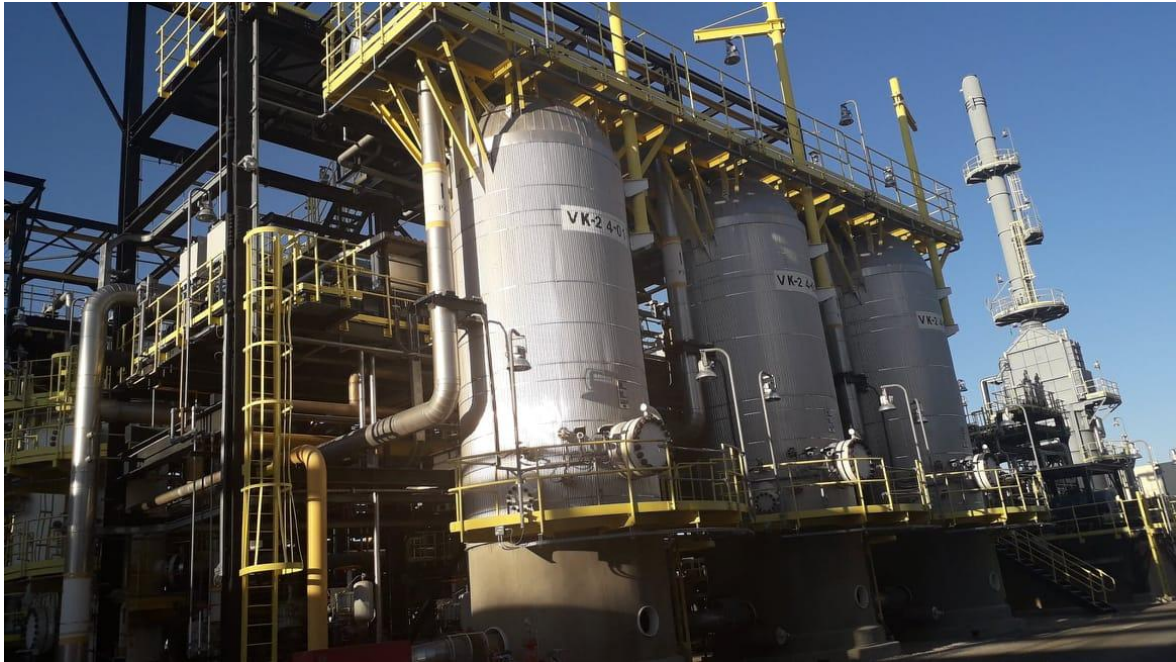
Figure IV.8: L'unité de déshydratation du gaz utilise trois sécheurs de tamis moléculaire dans RNS l'usine CPF.
