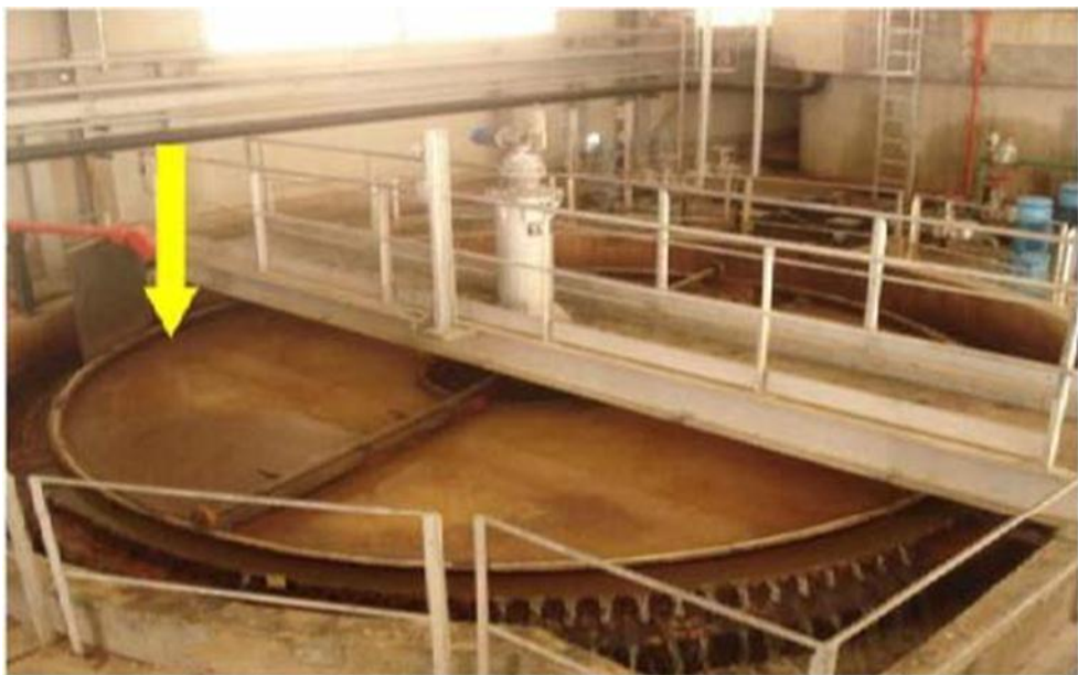
Figure 14: Cuve d'eau traitée
