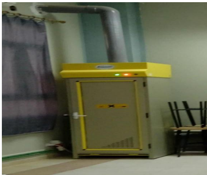
Annexe 06 : Armoire de stockage sécurisée des produits chimiques
