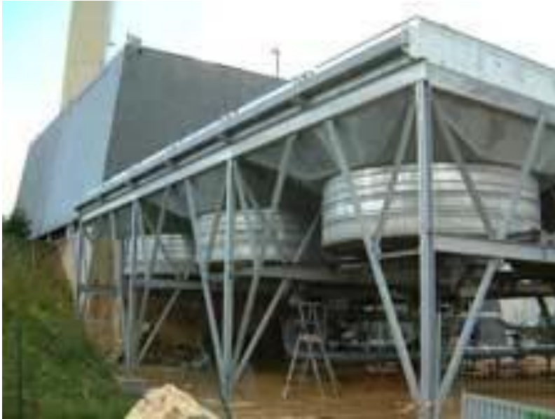
Figure IV. 24: Exemple d'aéro réfrigérant[4].
