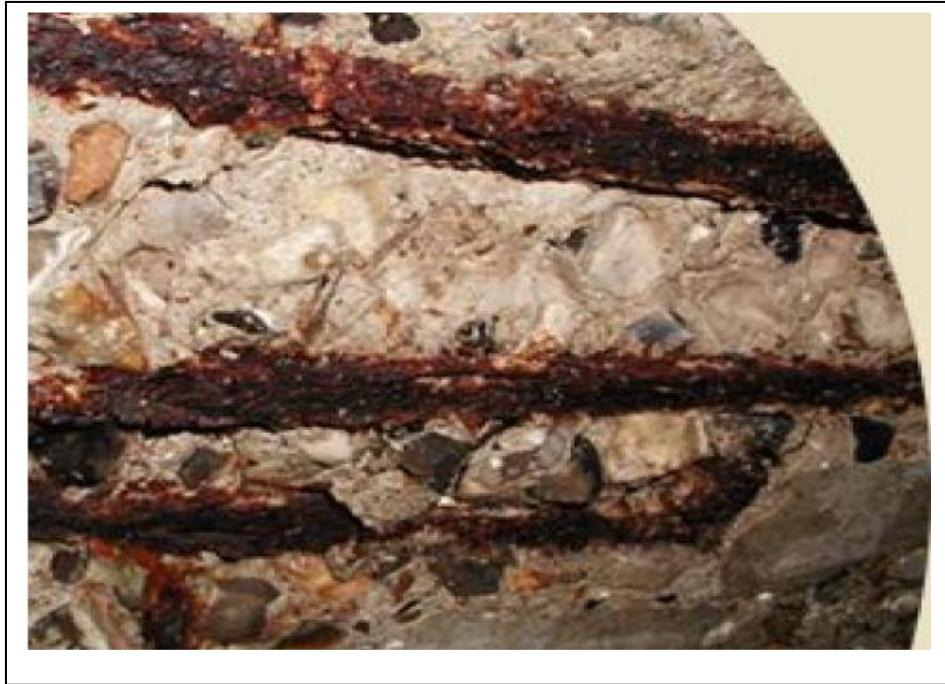
Figure I.11 : corrosion des armatures.
