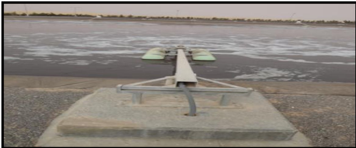
الصورة (3-3): الاحواض المهواة ( المرحلة الثانية B)
