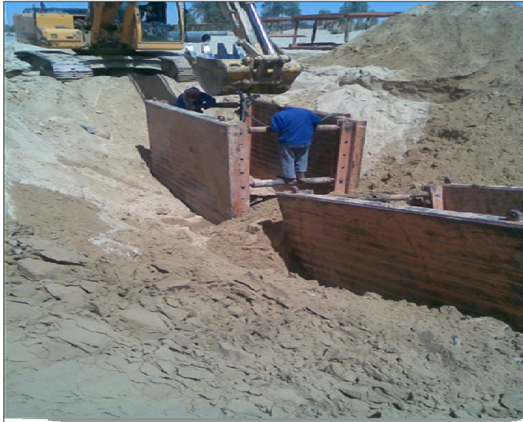
Photo VIII -1 : La protection contre les éboulements.
