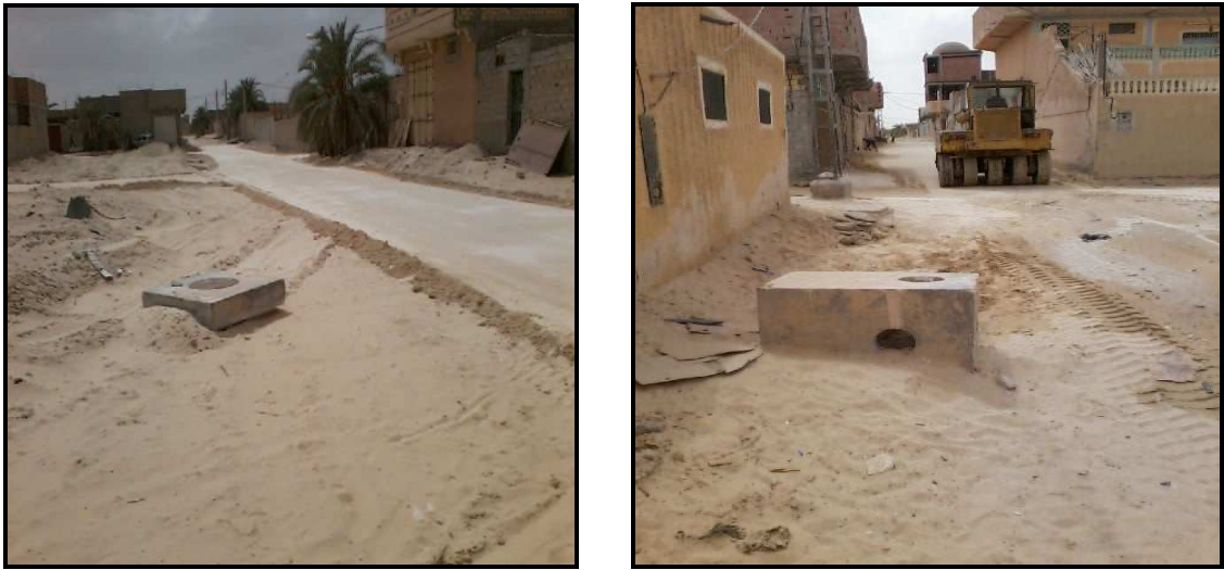
Photo II-7: Tampon du Regard et boîte de branchement arraché par entreprise de route
