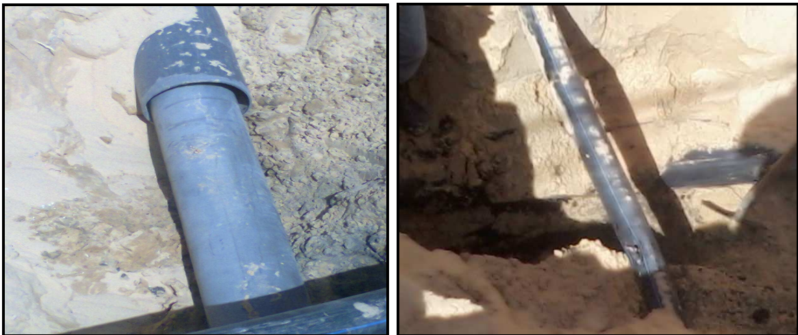
Photo II-8: Conduite d'Assainissement arraché par entreprise d' AEP
