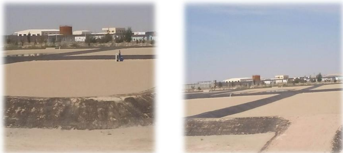
Figure N° III. 14: Lit de séchage des boues.
