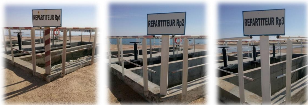
Figure N° III. 10: Répartiteur vers les bassins d'aération.
