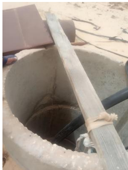
Photo III.3 Puits SARL TLMIN
