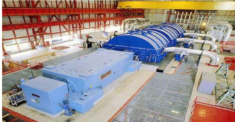
Figure I-2 : Alternateur de forte puissance 1300 MW - 1500 t/min- 50Hz triphasé.
