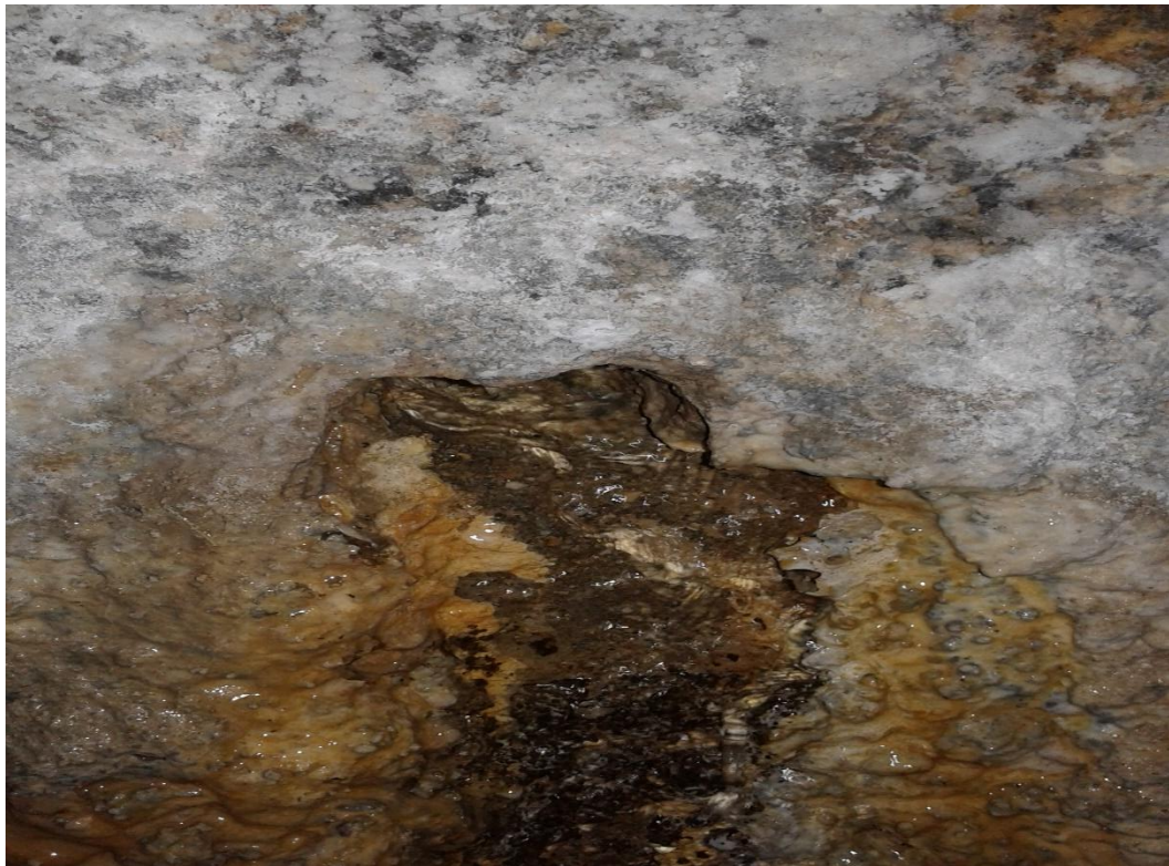
Photo 04 : fuit sur le mur de tunnel (en bas)
