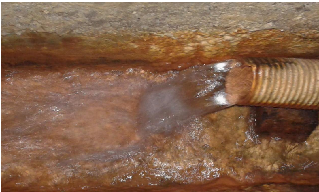
Photo 01 : débit de fuite d'eau
