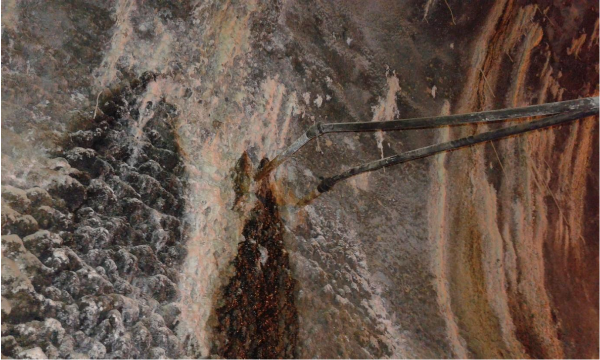
Photo 05 : fuit sur le mur de tunnel (en haut)
