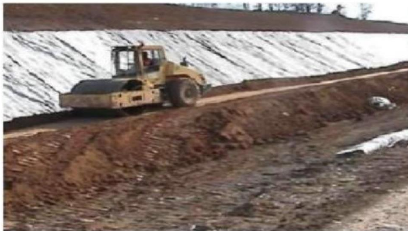
Figure 28: L'utilisation du géotextile en jouant un double rôle le drainage et le renforcement du talus
