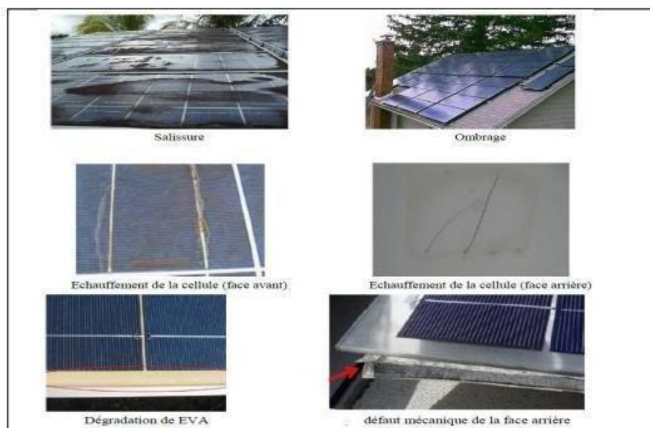
Fig. II .1 : Exemples de défauts rencontrés dans les générateurs photovoltaïque PV
