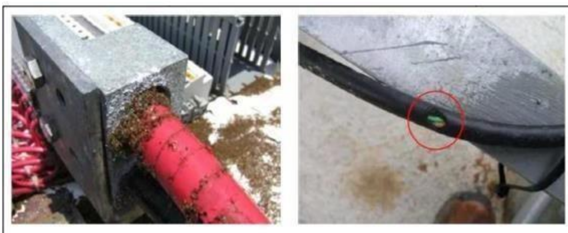
Fig.II .3 : Exemples de défauts rencontrés dans le câblage
