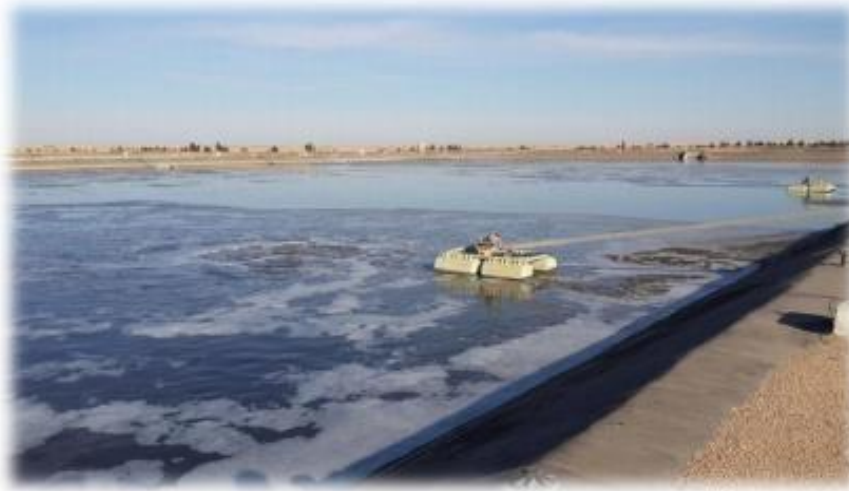
Photo 5 : Lagune aérée step 2.
