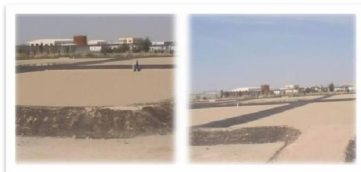
Photo 8 : lits de séchage des boues.
