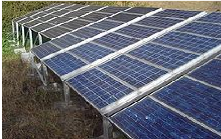
Figure (I.3): Centrale solaire photovoltaïque.
