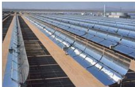
Figure (I.4): Centrale solaire thermodynamique.
