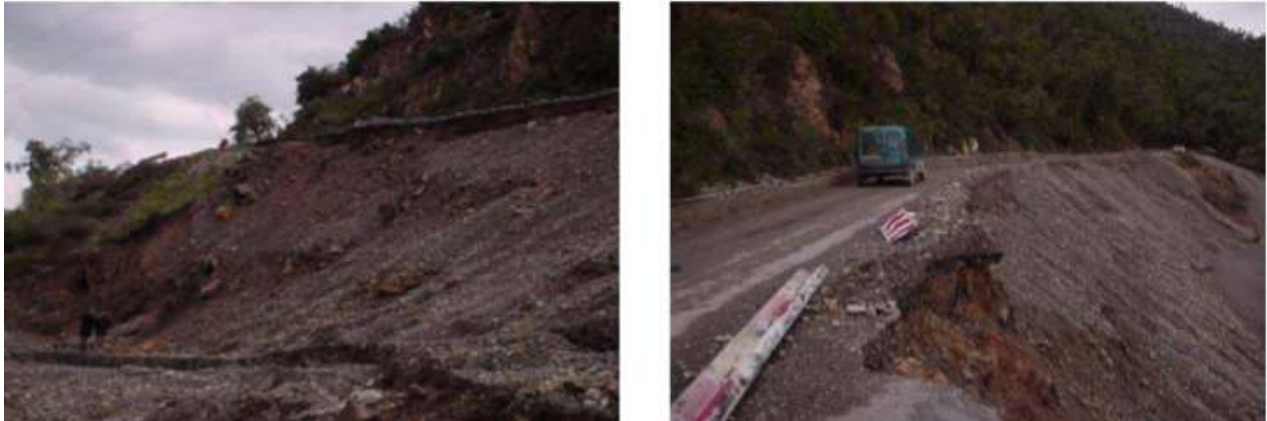
Figure II-38– Vue du glissement.
