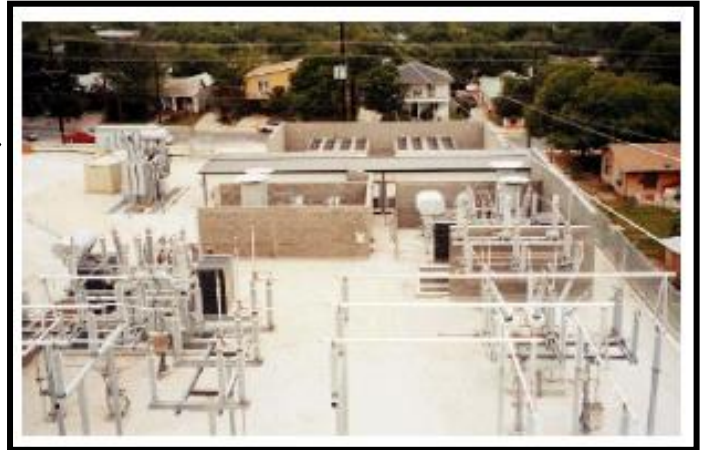
Figure II.5 STATCOM installée dans le réseaux électrique
