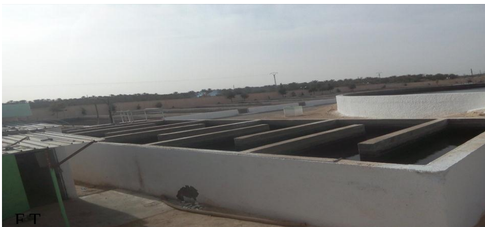
Photo.7 : Bassin de chloration.
