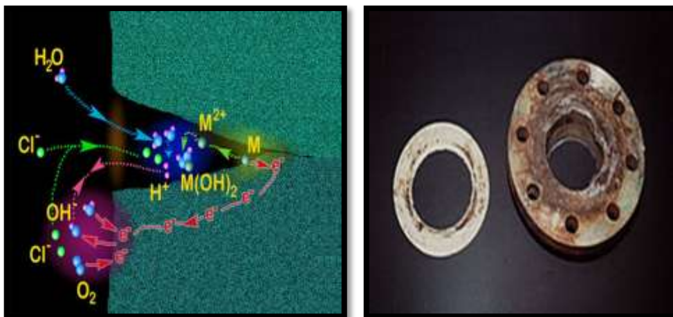
Figure I.4. Corrosion cavernueuse d'un acier allié sous un joint.
