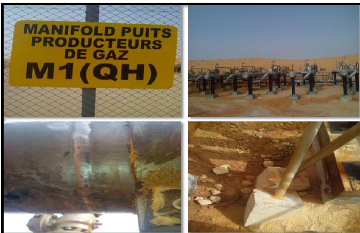
Figure III.2. Percement au niveau de manifold M1 (QH). (Départ puits RNZ120 vers usine du CPF)
