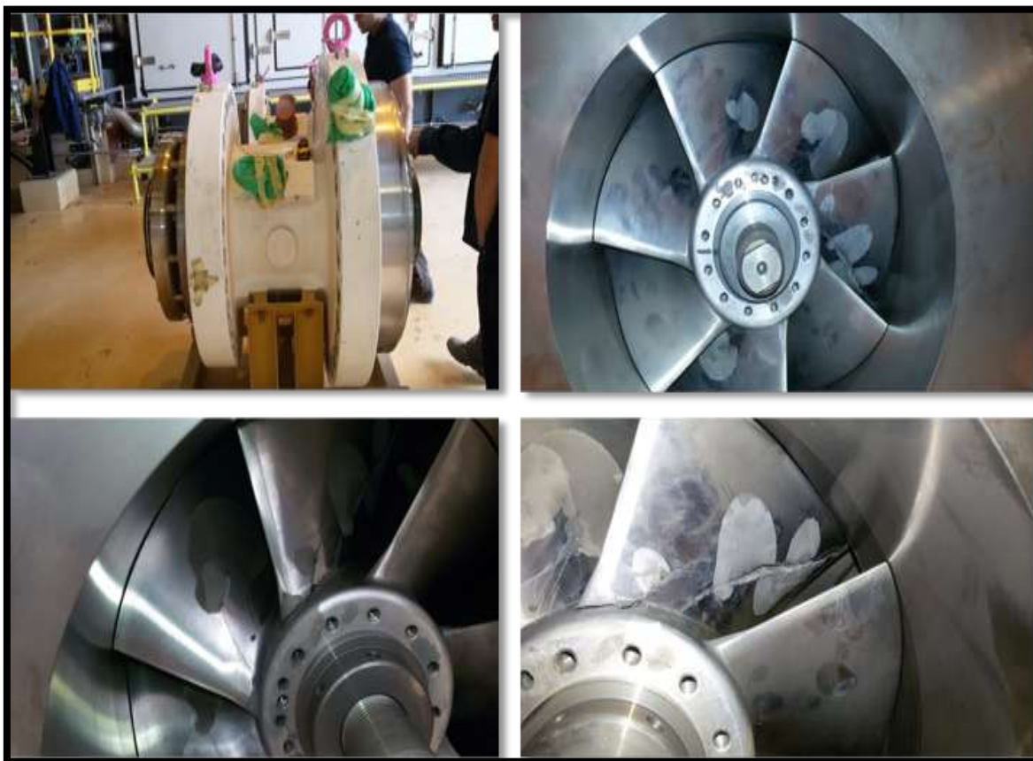
Figure III.1. Fissuration de la roue du turbo-expandeur.
