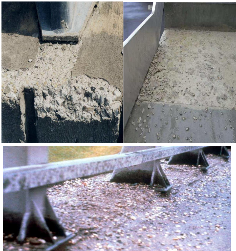
Figure 1.4: Les dégradations dues au Gel
