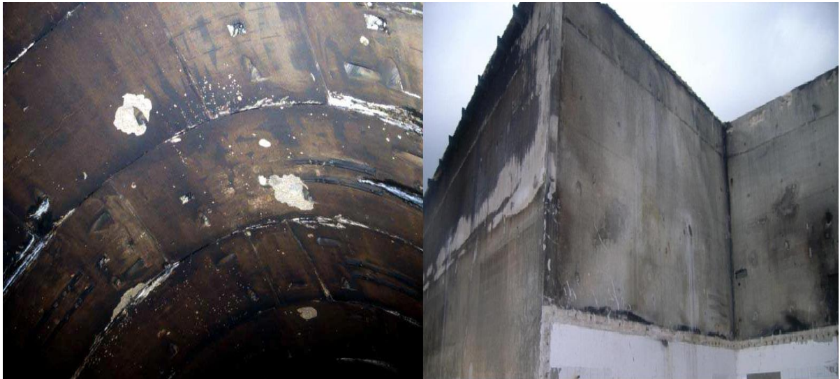
Figure 1.3: Désordres dus à l'incendie
