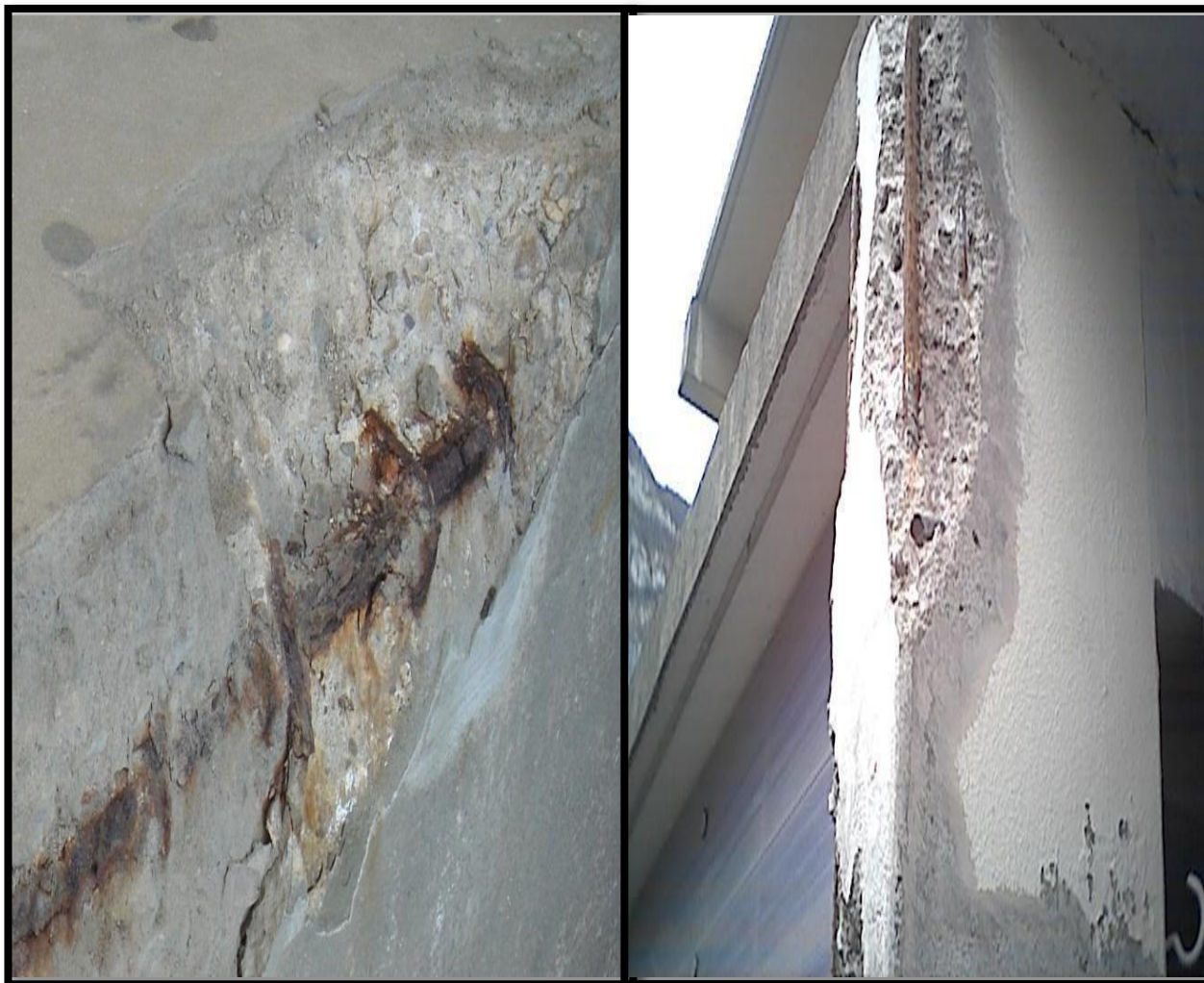
Figure 1.6: La carbonatation d'un morceau de béton a induit une corrosion du renfort avec un effritement du béton armé
