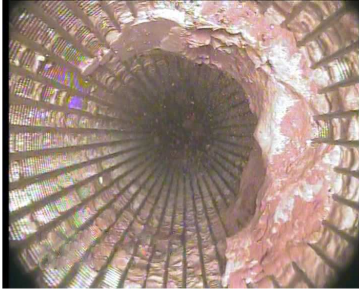
Figure IV.2 : le colmatage de crépine en acier inoxydable
