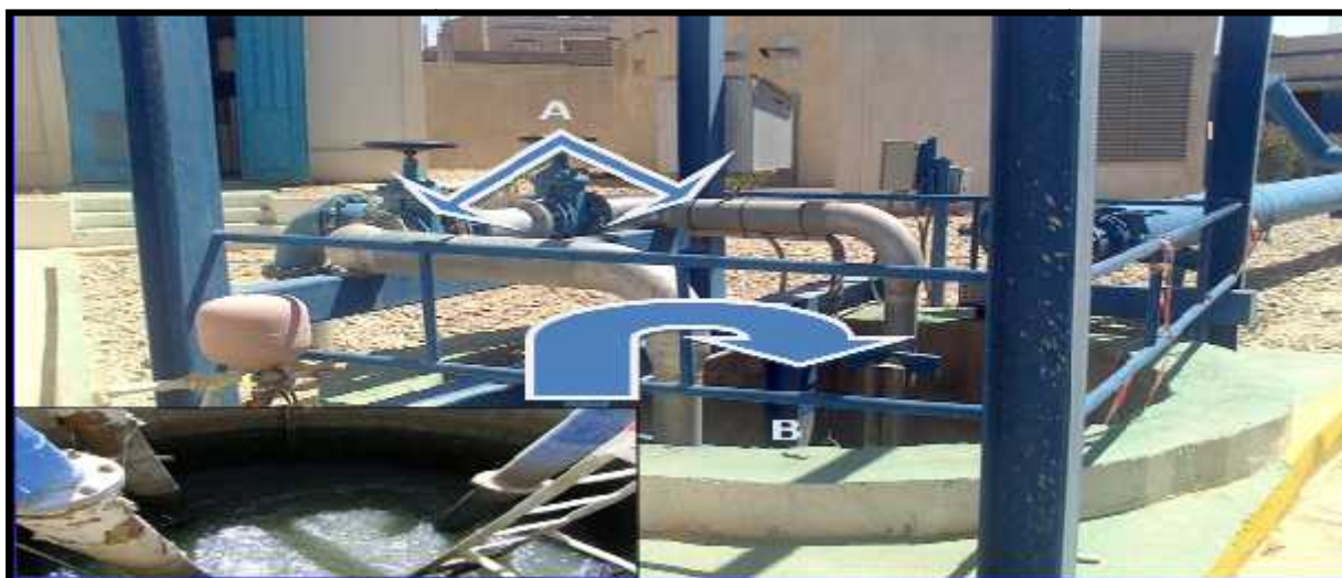
Photo. N°: (V. 01): Station de pompage des eaux de drainage ST10 (A) Conduite de refoulement vers le canal de collecte (B) Puits de collecte
