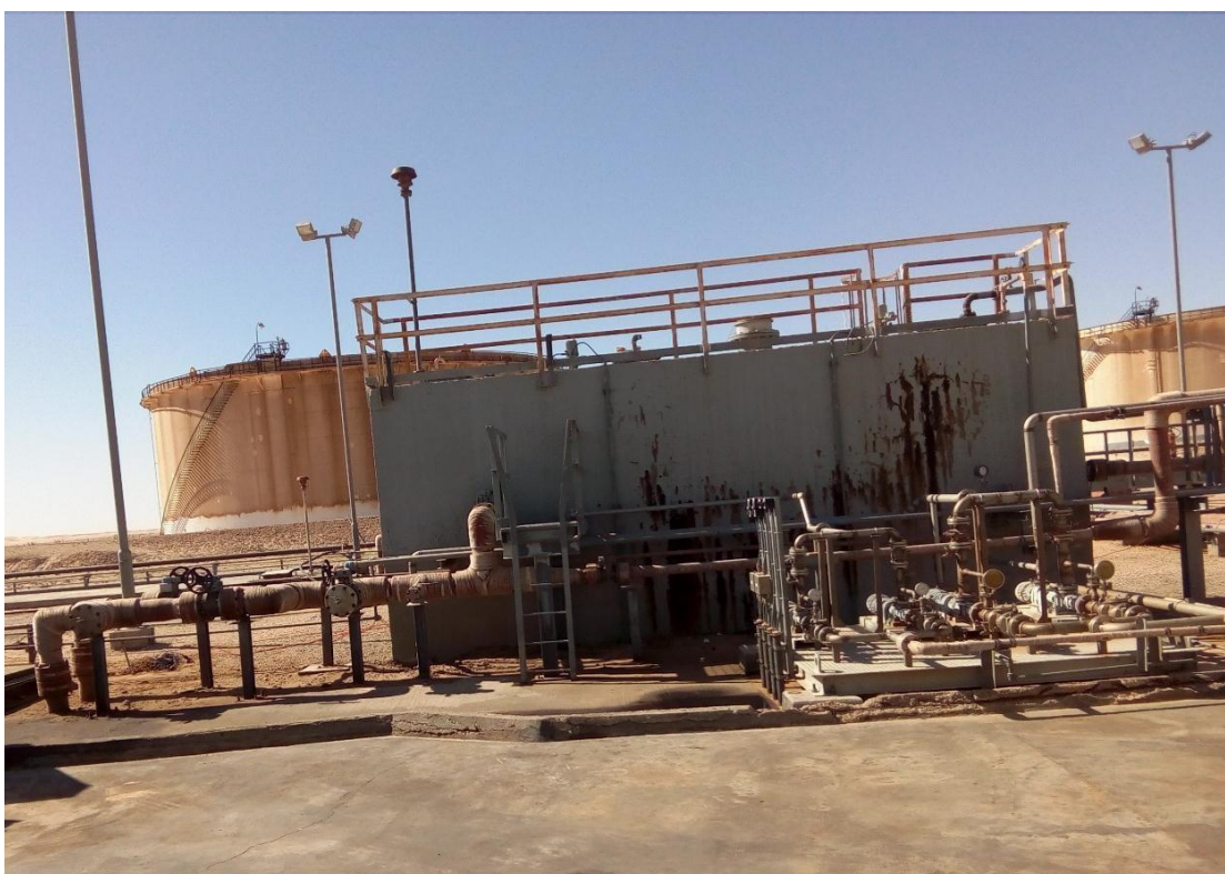
Figure II.12: Système de récupération des huiles et drainage de l'eau.
