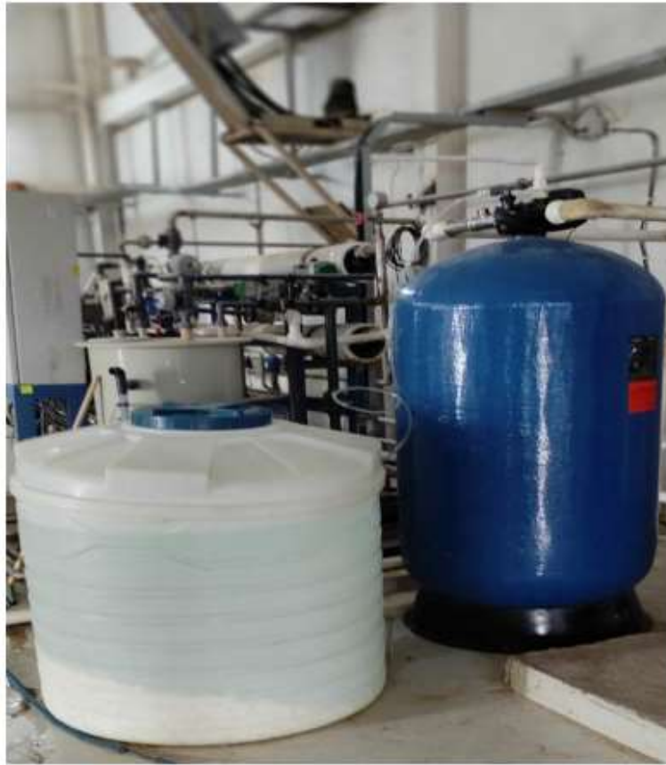
Figure VI.3 : Adoucisseur utilisé dans le cadre du traitement des eaux en milieu industriel.
