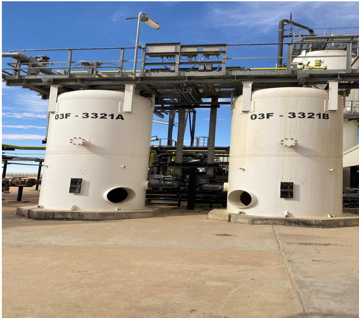
Figure 10: filtres multimédia (03F-3321A/B)
