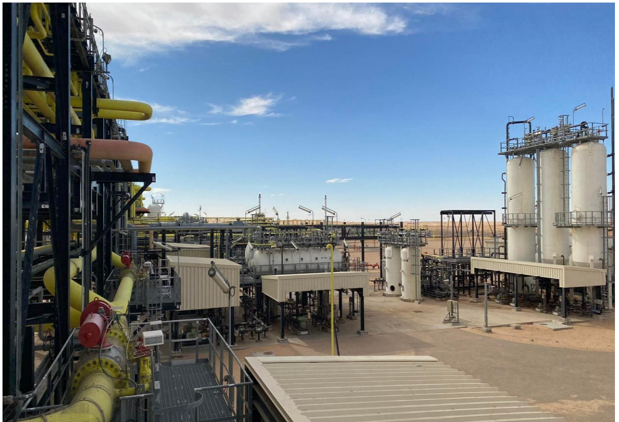
Figure 11: area de l'unité de traitement des eaux huileuses
