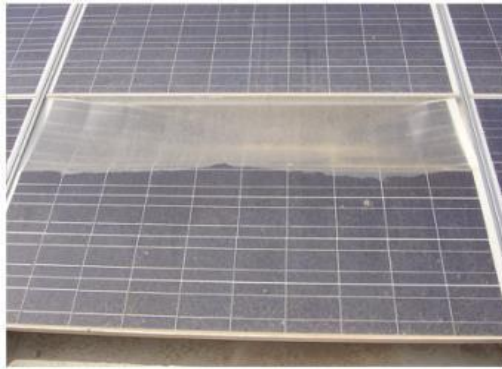
Figure III-7: défaut de délaminage[29]
