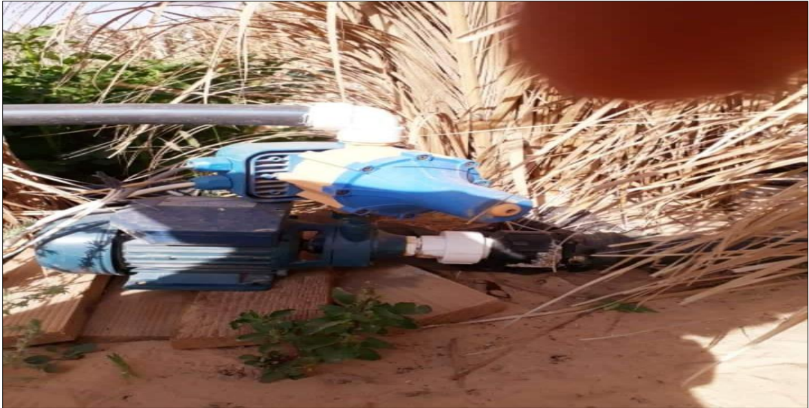
Figure 21 : photo montre la Pompe d'eau.
