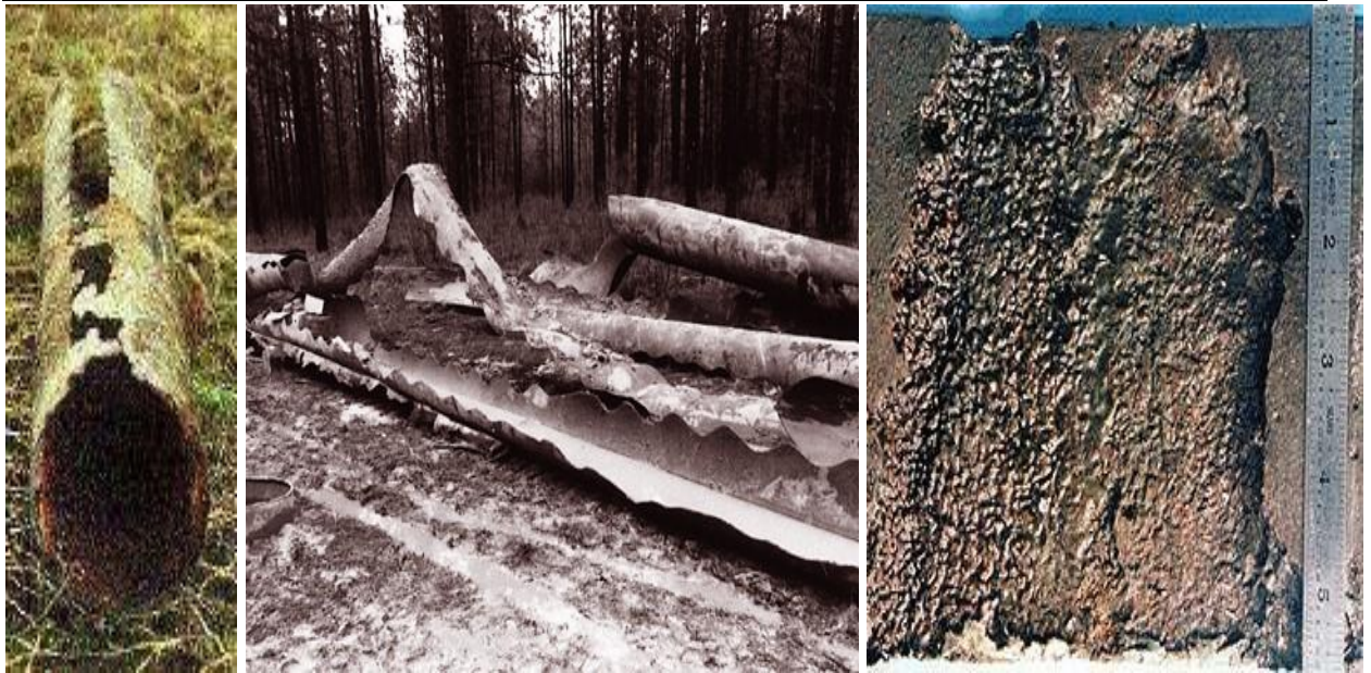
Figure II.5 Exemples de corrosion avec de l'hydrogène sulfuré [9]
