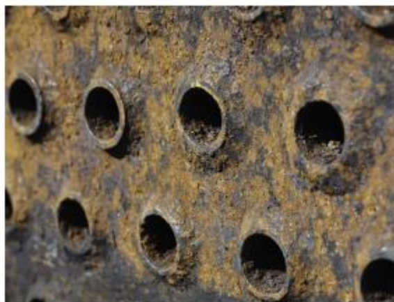
Fig II.4: Plaque tubulaire et tubes corrodés.
