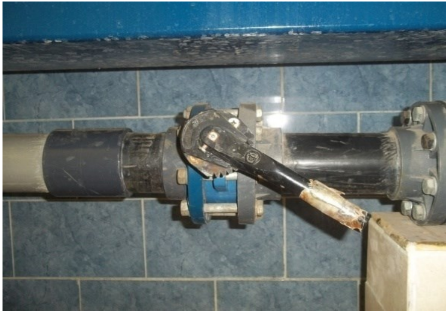
Photo IV.8 Vanne de régulation
