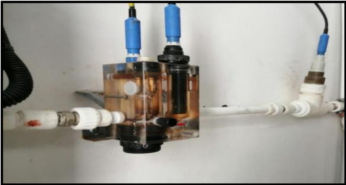
الشكل III-14: صورة توضح مضخات الكلور.
