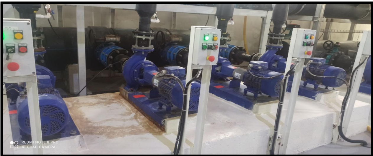
الشكل III-8: صورة توضح مضخات تغذية مرشحات الخرطوش .
