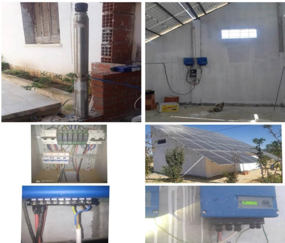
Figure 5: Certaines des photos d'un système de pompage photovoltaïque dans une ferme
