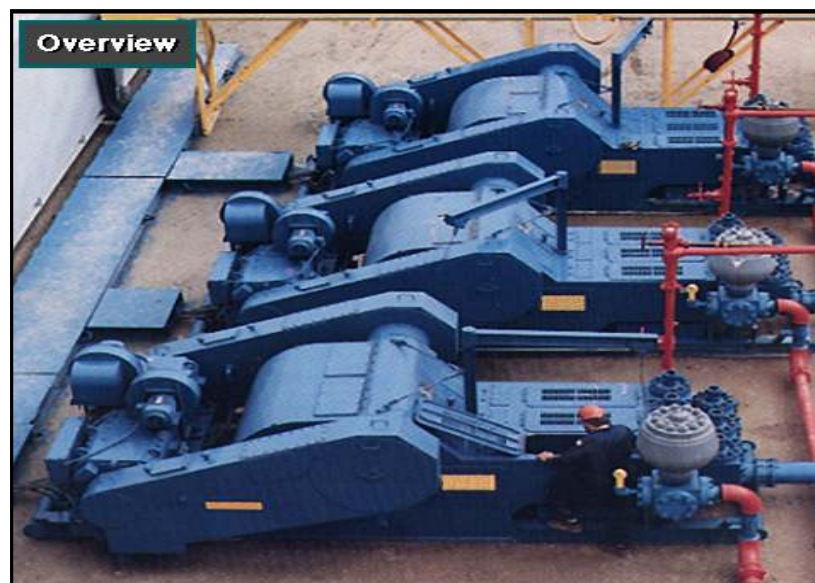
Fig. I.9 : Les pompes de forage
