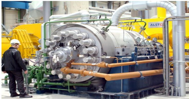
Figure 4.2 : Photo d'une pompe dans une centrale à vapeur.
