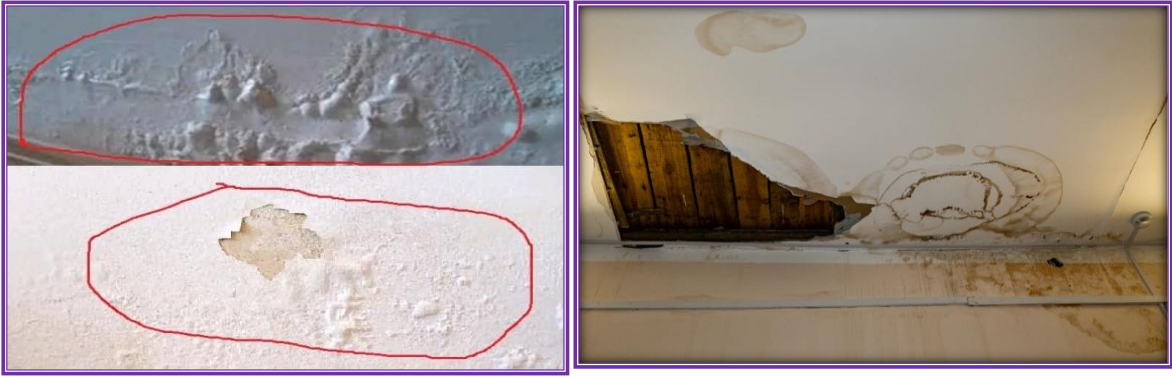
الشكل (14-I): صور توضح آثار الرطوبة والتآكل على الأسقف والجدران [35].
