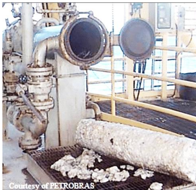
Figure 1: Bouchon d'hydrate obtenue après raclage de la conduite
