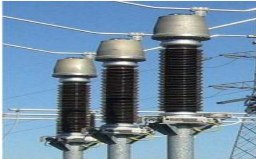
Figure III-4: Transformateur de tension. [21]
